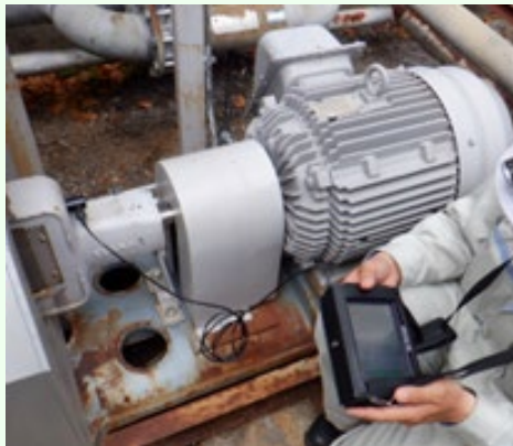
ポンプの振動測定
