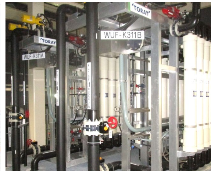
海水淡水化設備
