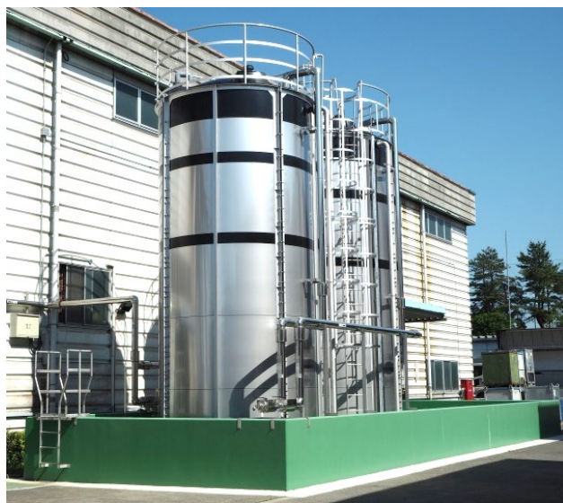
屋外原料タンクヤード
