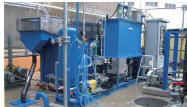
一般排水処理設備
