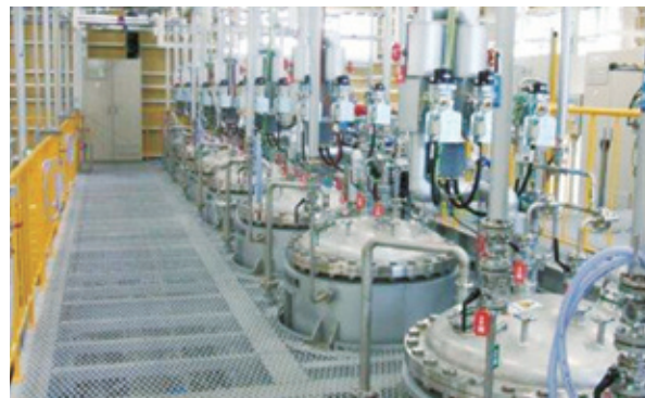
機能膜利用濃縮装置
