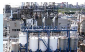
合成樹脂製造プラント
